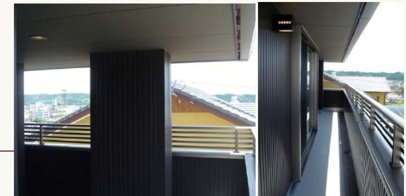
■2Fバルコニー この家の大きな特徴の1つが、広々としたインナーバルコニー。洗濯物を干したり、夕涼みをしたりと、様々な用途に使用できます。外観的にも建物の彫りの深さを感じさせる陰影を作り出しています。
